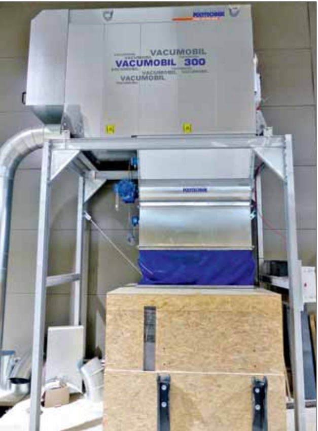
Der Mobilentstauber wurde so hoch aufgeständert, dass neben der Zellenradschleuse (zur Sicherheit) auch ein großer Behälter für die Späne darunter Platz findet.
