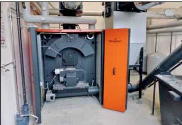
Blick auf den Kessel mit geöffneter Verkleidung, rechts ist die Aschetonne zu sehen, in der Mitte hinten der Zyklonfilter.
