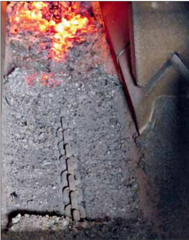
... weshalb Höhle auf das robuste Kettensystem in Heizomatkesseln (hier im Gluterhaltungsbetrieb) gesetzt hat.
